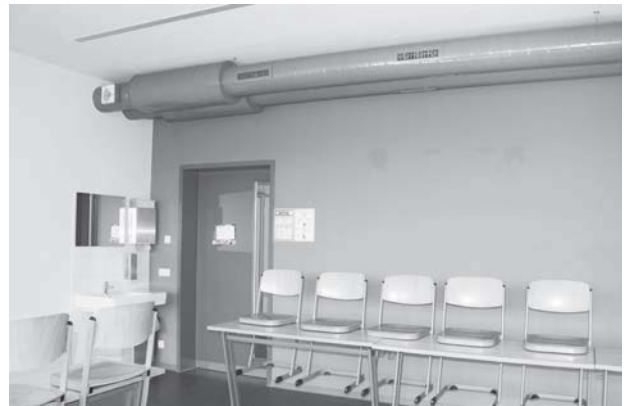
© Dr. Andrea Staar Lüftungsanlage in einem energetisch sanierten, denkmalgeschützten Schulgebäude
